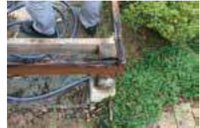
天然木デッキの土台の腐り
