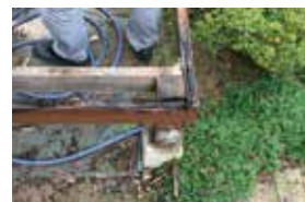
天然木デッキの土台の腐り
